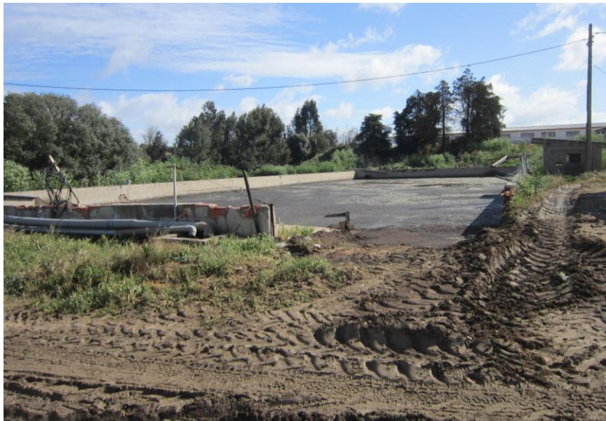
Fotografia 7: Tanque de receção.
